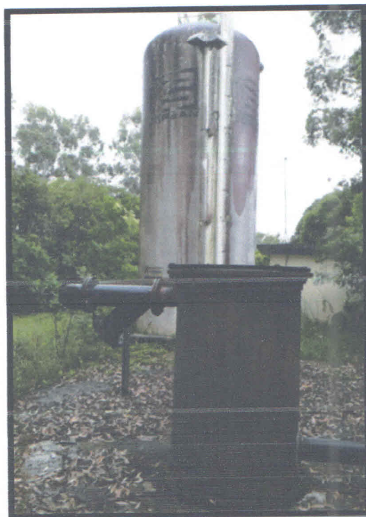
Figura 11 – Vista do poço de Água Bruta.
