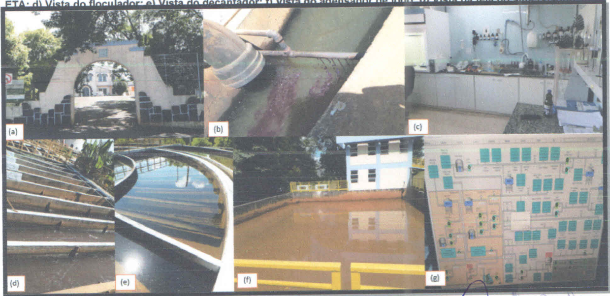
Figura 13: Vistas da ETA I de Erechim: a) Vista da entrada da ETA; b) Vista da calha Parshall; c) Vista do laboratório da ETA; d) Vista do floculador; e) Vista do decantador; f) Vista do adensador de lodo; g) Vista da tela do supervisor
