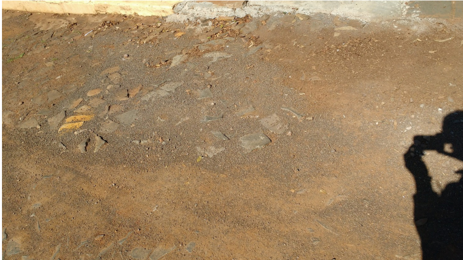
Recomposição razoável. Falta de compactação.
