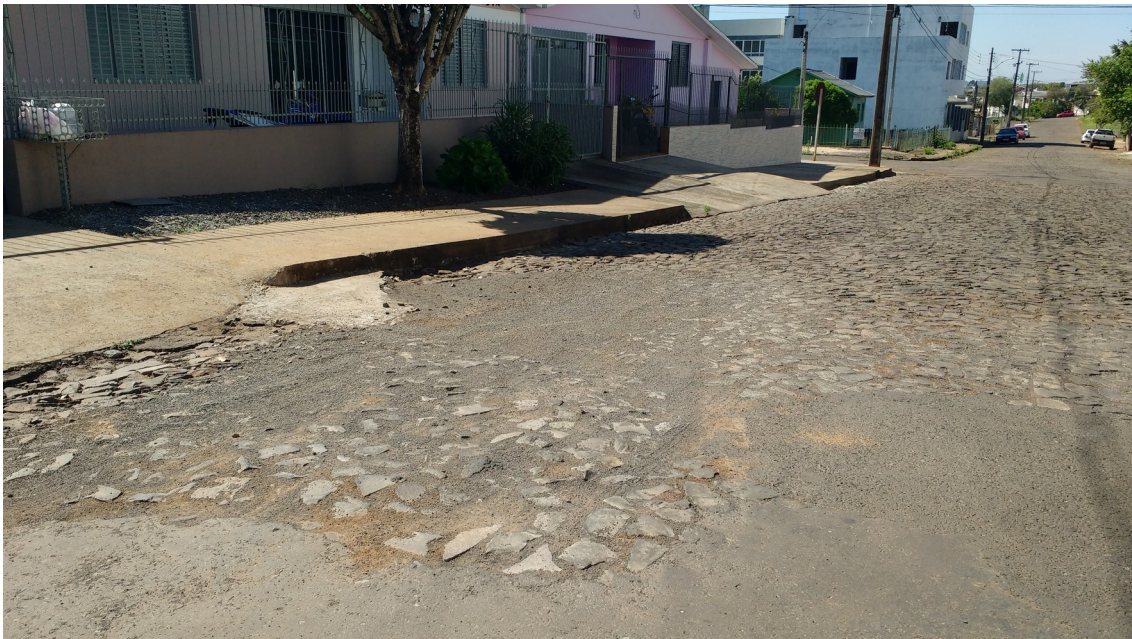
Recomposição razoável. Falta de compactação.
