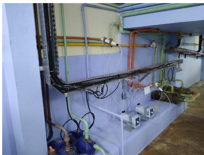
Foto 17 – Dosadores de cloro e flúor
