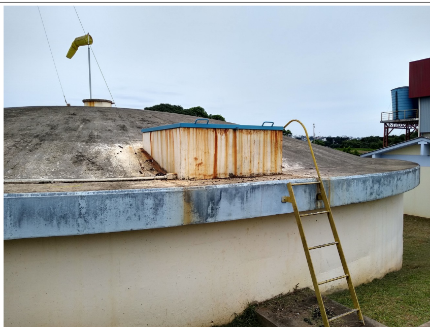
Foto 25 – Tampa da abertura de inspeção
