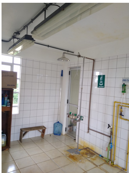
Foto 22 – Chuveiros/lava-olhos de emergência
