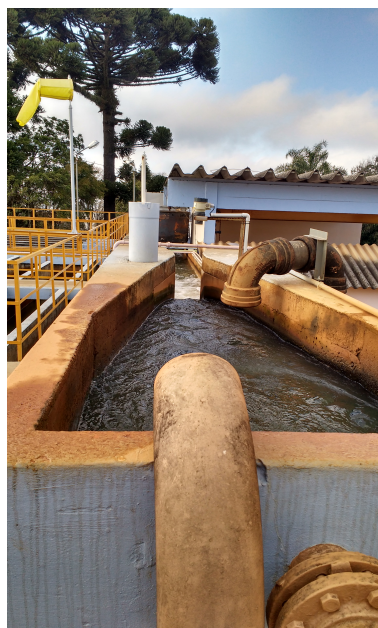
Foto 14 – Calha Parshall e medidor de vazão
