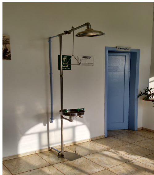
Foto 11 – Chuveiros/lava-olhos de emergência
