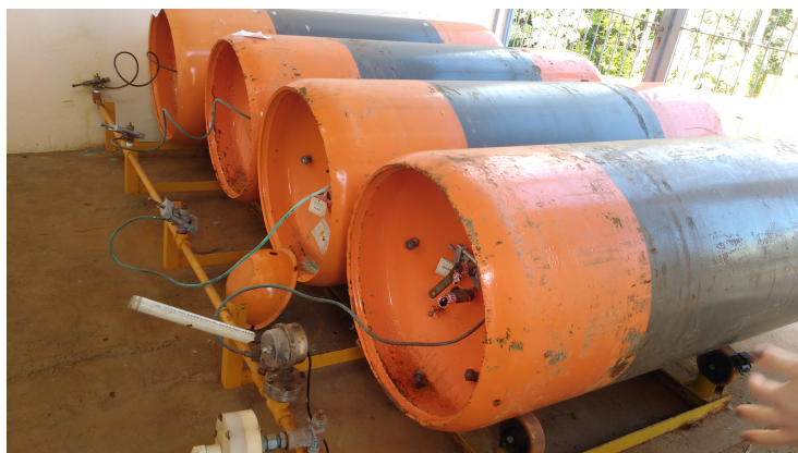
Foto 3 – Cilindros de Cloro
