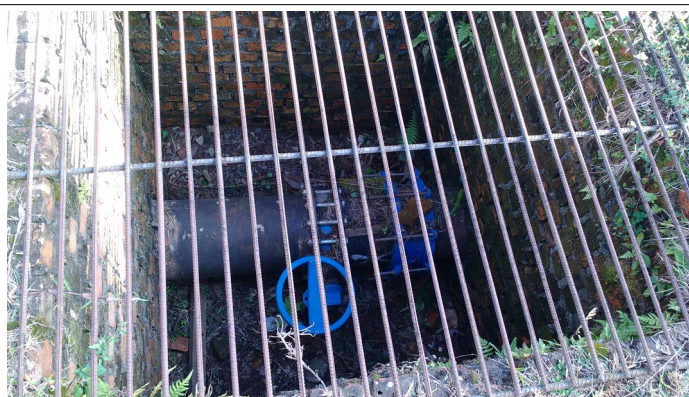
Foto 19 – Grelha sobre câmaras de registros
