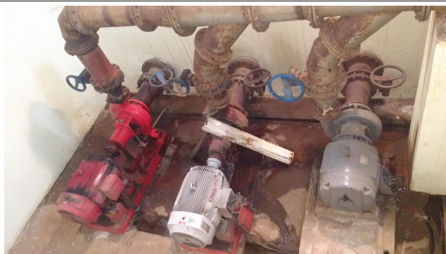
Foto 21 – Conjunto motobomba reserva instalado
