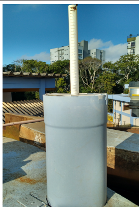
Foto 6 – Medidor de vazão Calha Parshall
