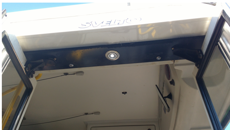
Foto 5 – Luminária do poço de degraus
